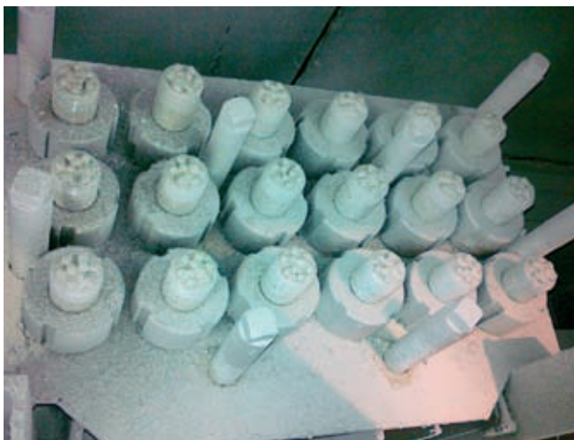
Rys. 3. Widok zakotwień czynnych przystosowanych do kontroli siły w poszczególnych kablach dźwigarów dachowych
